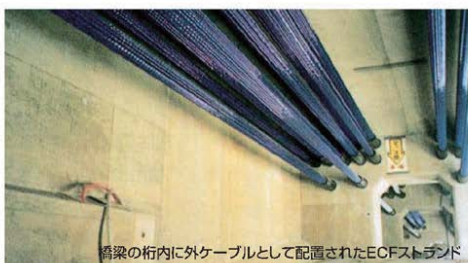
橋梁の桁内に外ケーブルとして配置されたECFストランド
