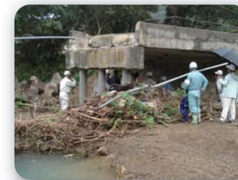
災害査定臨場状況
